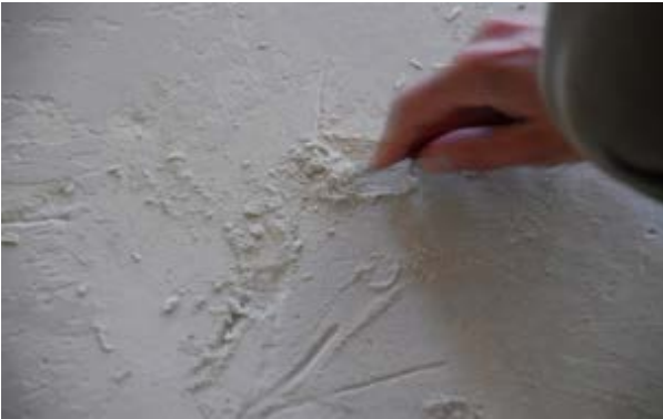
Labile Oberfläche in einem Calciumsulfat-Estrich
