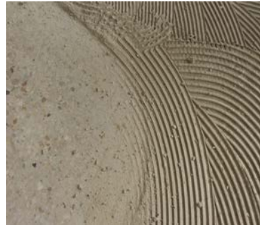
Teilweise abgeschliffener Fliesenklebstoff
